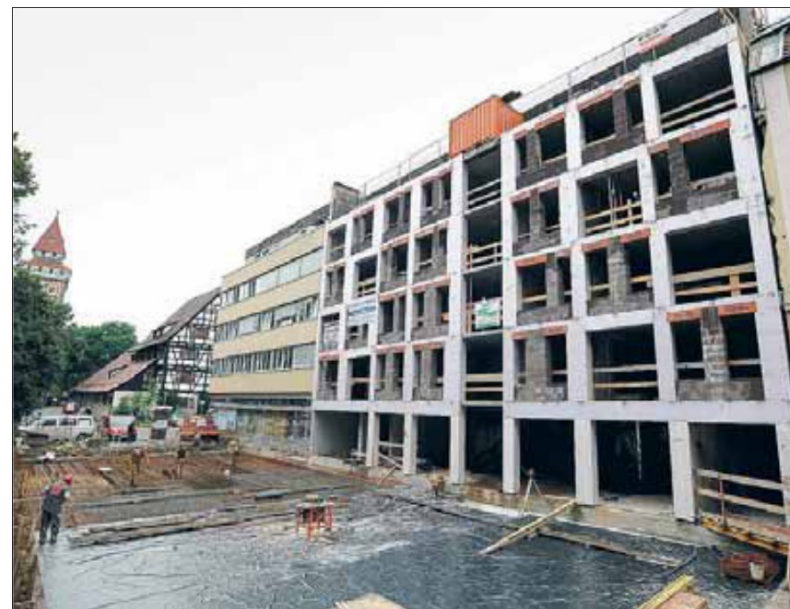
Im Rohbau sind die 27 Seniorenwohnungen am Gemalten Turm fertig. Hier der Blick von der Mauerstraße aus. Fotos: Wynrich Zlomke
